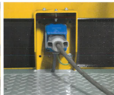
Linea elettrica 230 V in piattaforma con salvavita 230V electric power line on platform with circuit breaker
